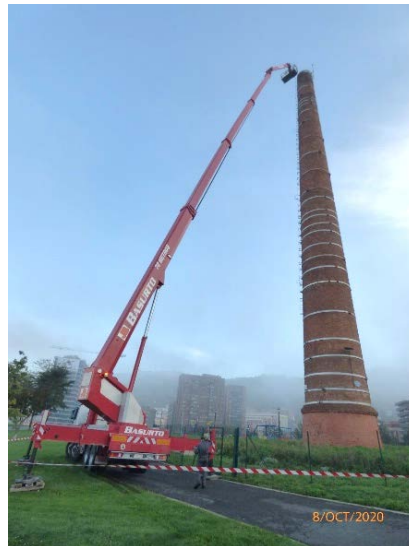
Figura 6: Vista general de la plataforma utilizada para la inspección exterior y preparación de trabajos verticales por el interior.
