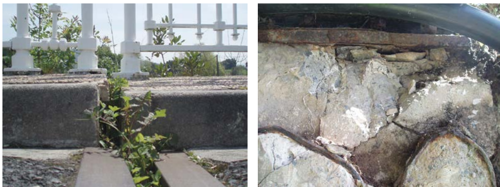
Figura 5: Desnivel existente entre tramos de tablero, sobre Pila 3, y cata realizada bajo uno de los apoyos de dicha pila.
