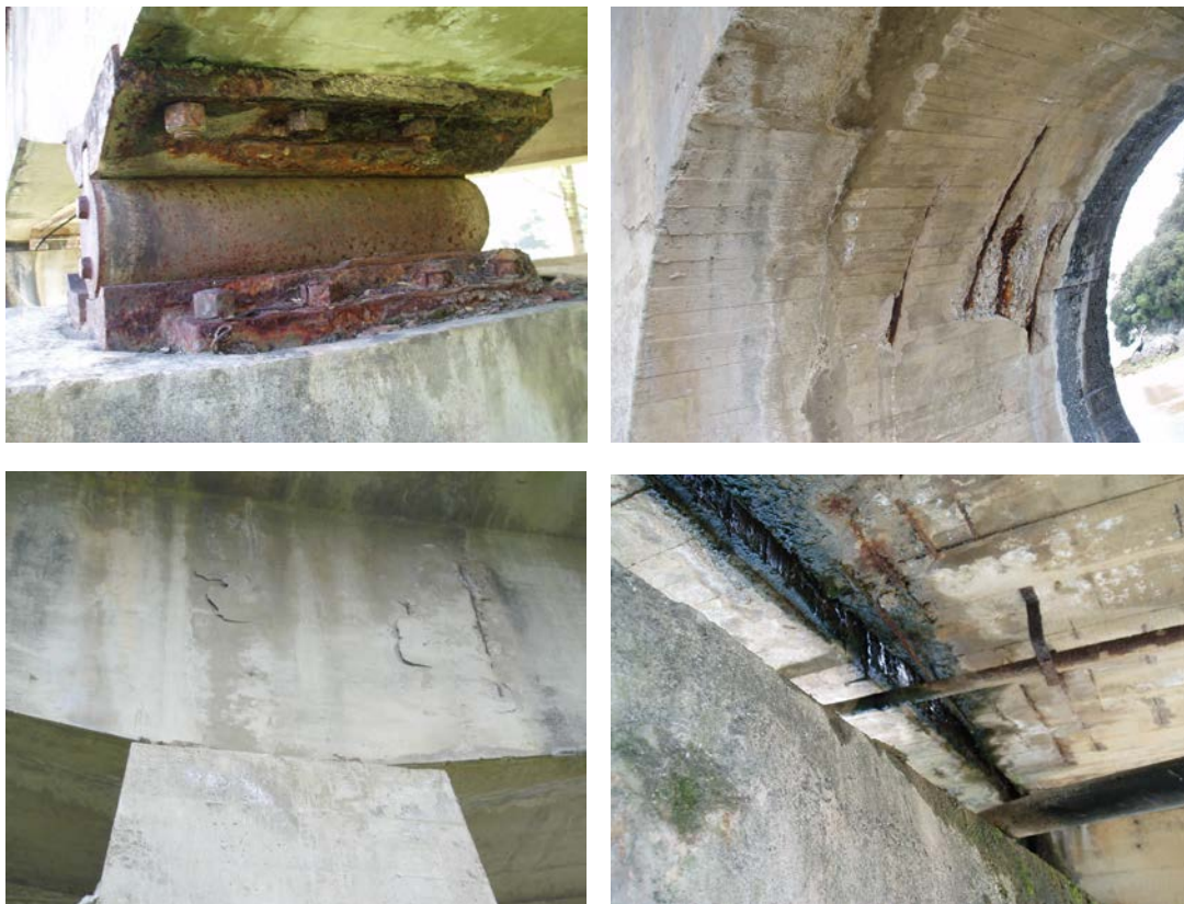
Figura 6: Ejemplos de daños observados en la estructura del puente.
